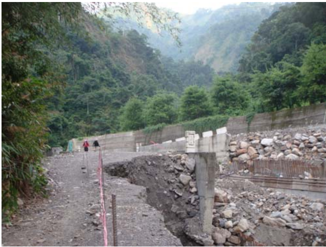
～ 崩塌的生利橋 ～
